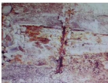
Κηλίδες σκουριάς στην επιφάνεια του σκυροδέματος
